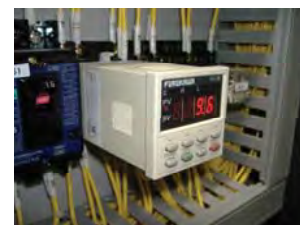
笠木ヒーター制御盤内にある温度調節器。9.6は現在の笠木表面温度。この設定器の設定温度を変更し省エネを図る。
