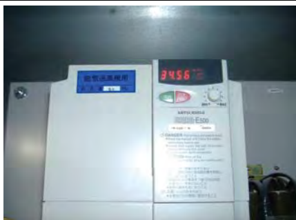
現在34.56Hzにインバーター制御し適正に運転している。この数値が50Hz付近から動かない場合は正常に機能していない可能性がある。
