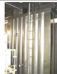
機械室にある還水槽
