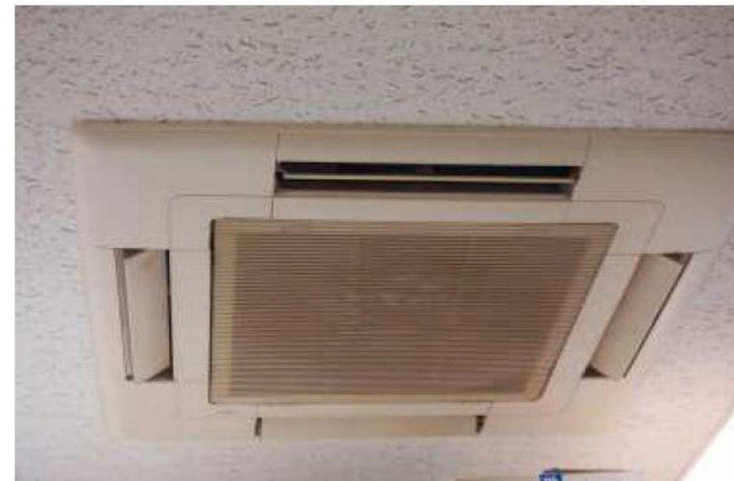
エアコン（天井埋込タイプ）
