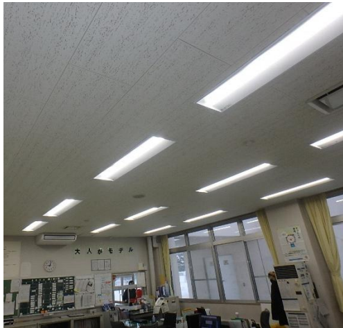
新設照明器具
