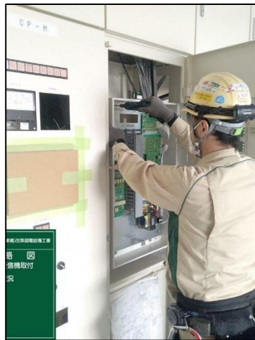
火災受信機取付状況
