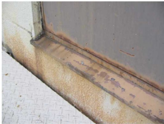
鋼製建具の腐食（水切）
