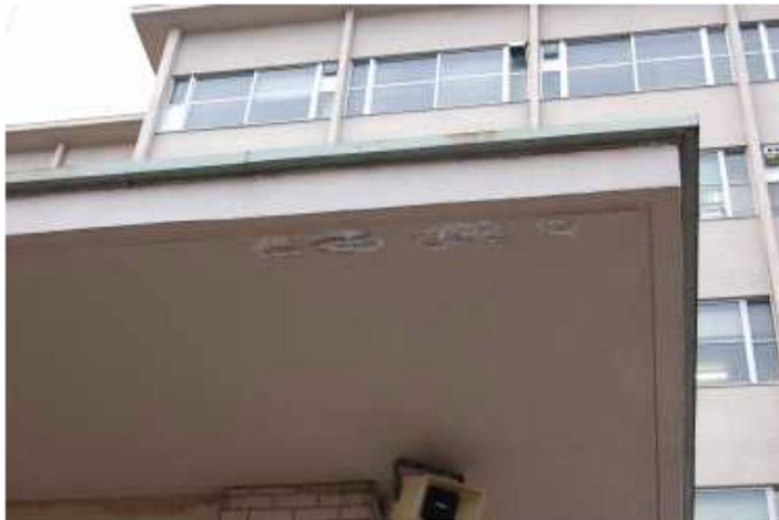
軒裏のはく離
