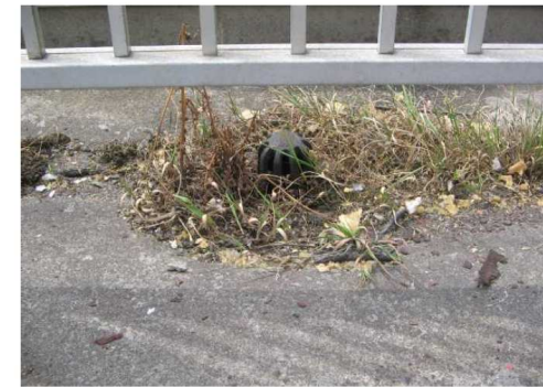
ルーフドレンの詰り(雑草が繁茂状態)
