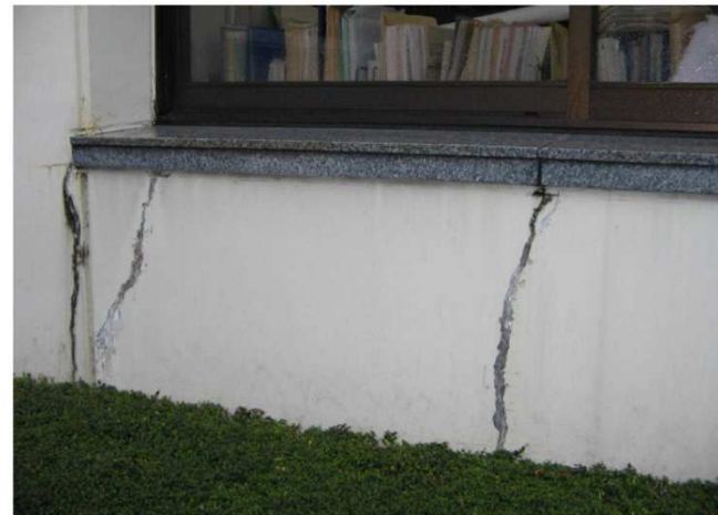
外壁仕上げのひび割れ
