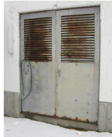
鋼製建具の腐食（ガラリ）
