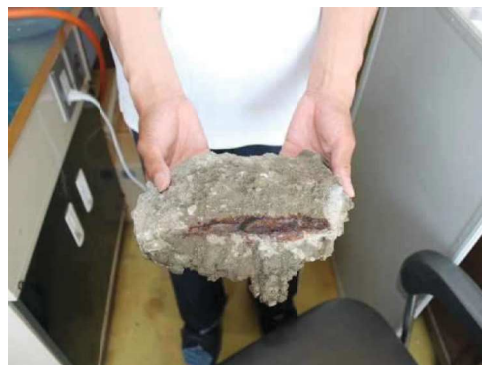
落下したコンクリート片
