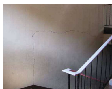
壁のクラック・モルタルの浮き
