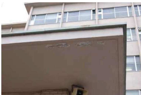
軒裏のはく離
