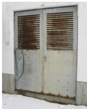
銅製建具の腐食（ガラリ等）
