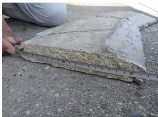
落下したモルタル
