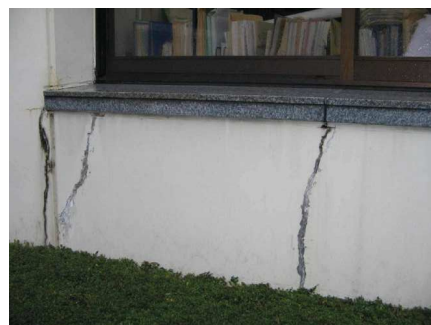
外壁仕上げのひび割れ
