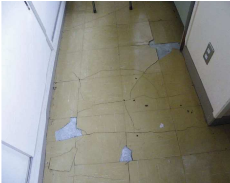
床仕上げの傷み
