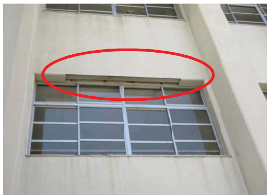
外壁の下端のモルタルが落下
