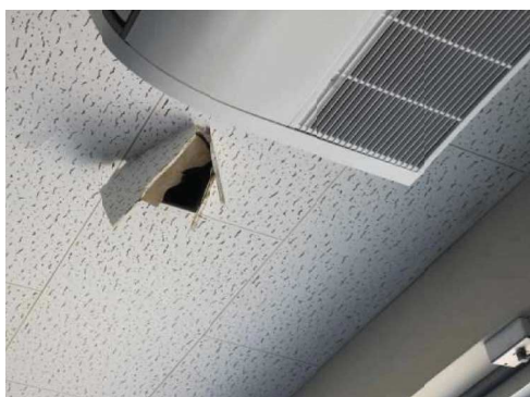
天井材を突き破ってコンクリート片が落下
