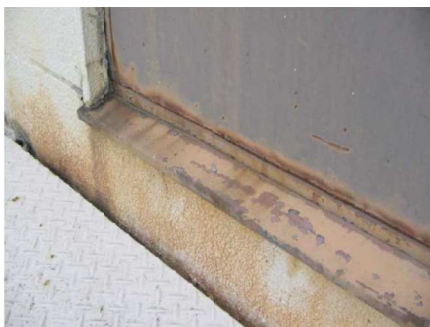
銅製建具の腐食（水切・建具に下端）
