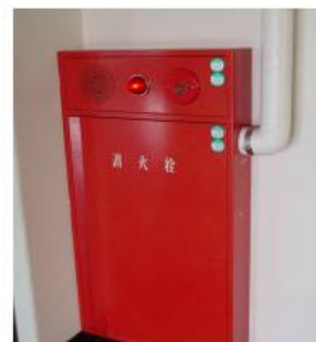
屋内消火栓箱（露出型）
