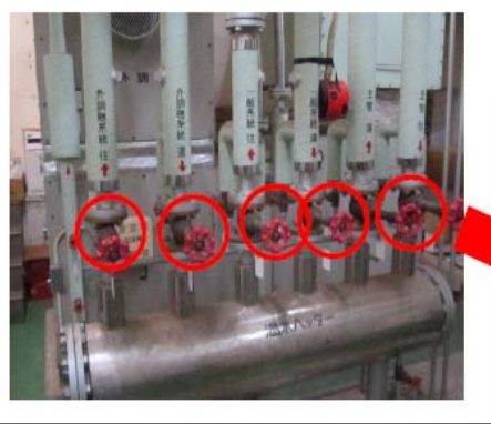
図4-1-(5) 夏期北地域の県有施設のボイラー室
