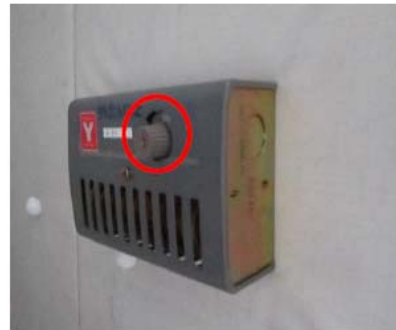
図⑥-3-(1) 東青地域の県有施設排気ファンのサーモ
