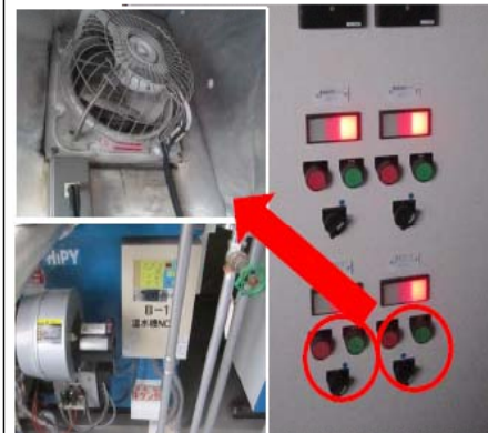
図⑥-3-(2) 東青地域の県有施設排気ファン
