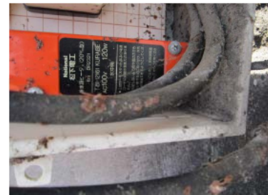
図⑦-1-(1) 東青地域県有施設のドレンヒーター (自己制御：サーモスタッド内蔵タイプ)
