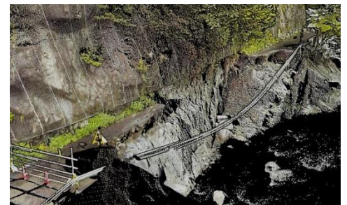
豪雨災害で崩落した道路の三次元データ
