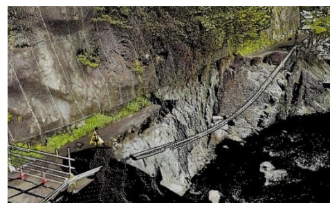
豪雨災害で崩落した道路の三次元データ
