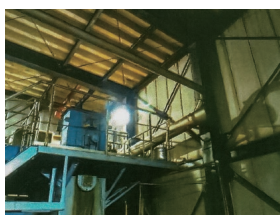
食油工場 LED照明
