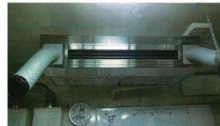
厨房用エアコン
