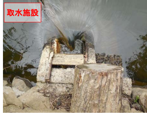
老朽化により蓋の開閉がしづらい
