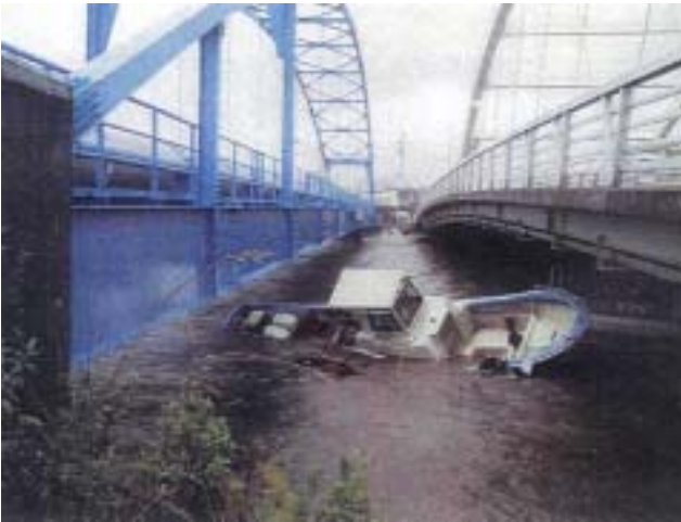
(出水時) 漂流、橋の損傷、河川水の流下阻害の恐れあり。
