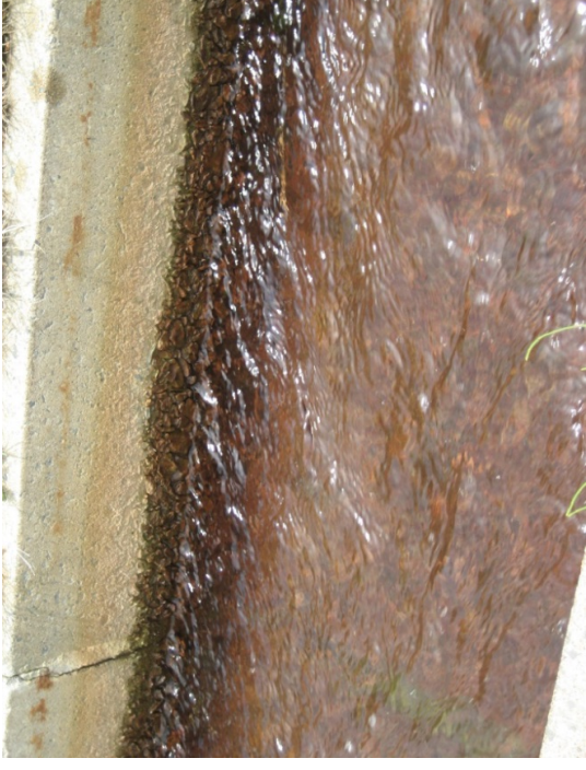
② 地区内水路の劣化状況(骨材が露出)
