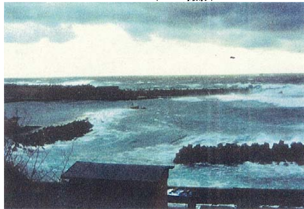
外郭施設の整備不足により、越波等が生じ、港内静穏度が非常に悪く、漁船の係留等に支障がある。
