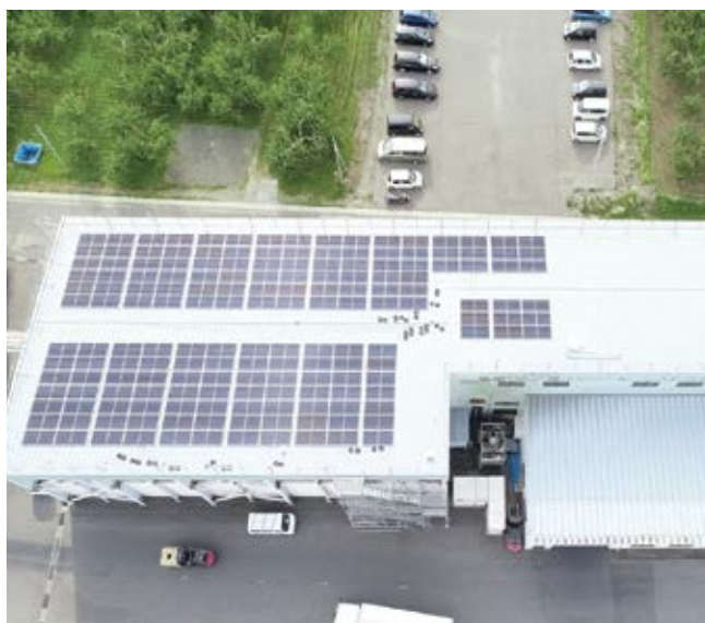
倉庫屋根太陽光発電
