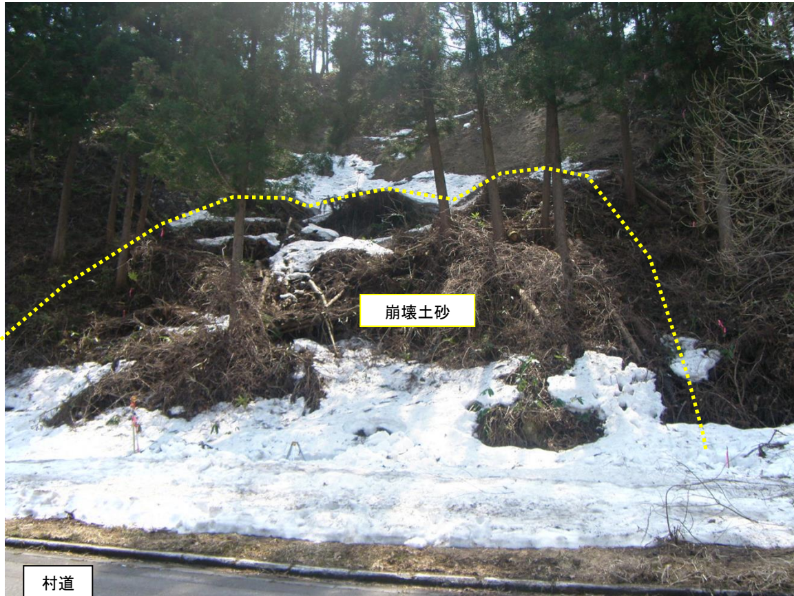
【事業実施前の山腹崩壊状況 写真③】 2工区全景
