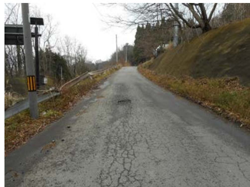
老朽化が著しい町道
