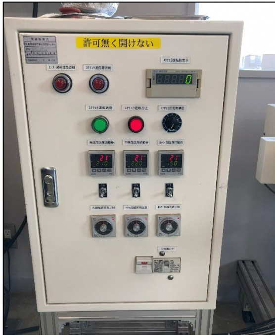
押出機の制御系
