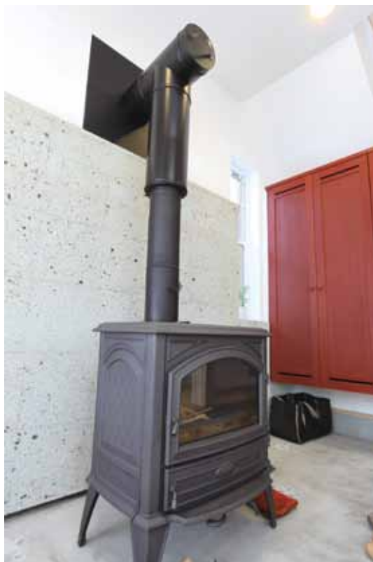
玄関の土間に設置された薪ストーブ
