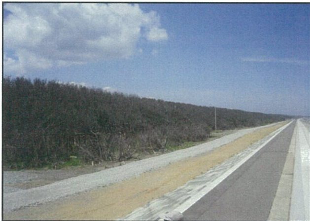
(イ) 現在のクロマツ枯損状況
