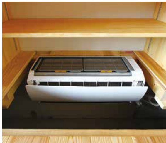
全室を冷暖房するリビングの床下に取り付けられたエアコン
