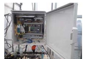
施設園芸の自動かん水・施肥装置
