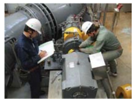
老朽化したポンプの機能診断
