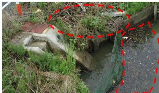
写真 38：取水部周辺の土砂やゴミの堆積
