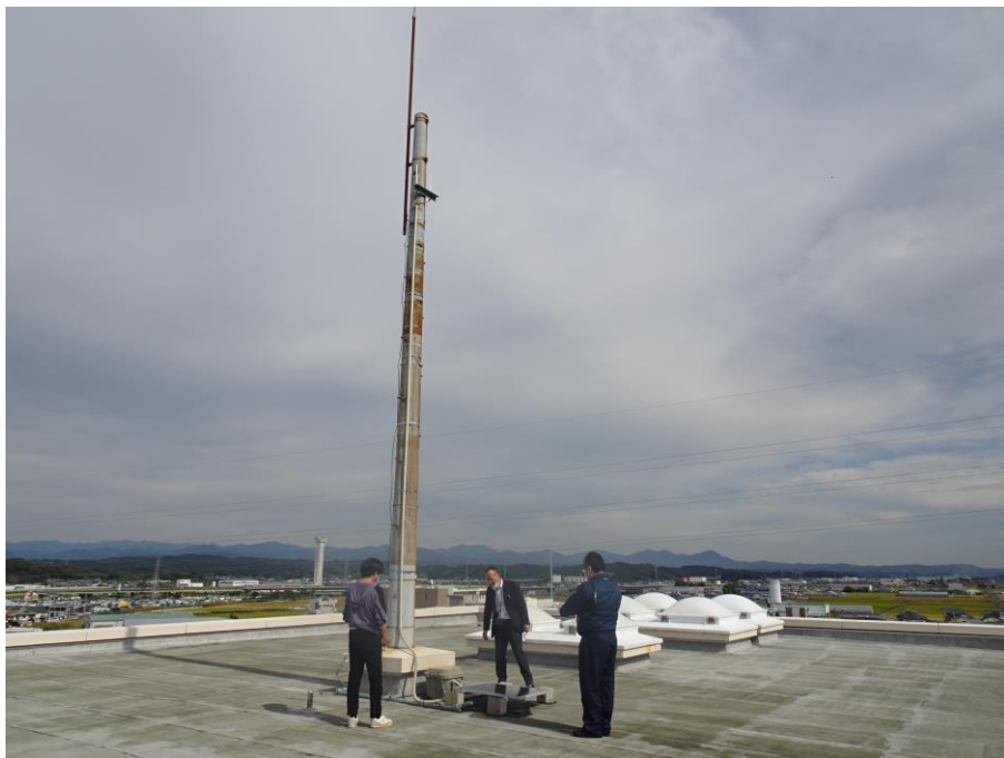
市庁舎屋上（避雷針に設置）
