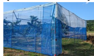
多目的防災網の設置
