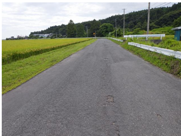
施工前の路面状況
