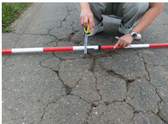
施工前の路面状況
