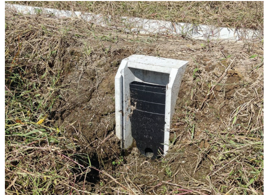
蓬田第一地区に設置した田んぼダム
