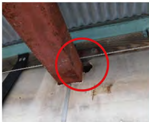
発生鶏舎壁面の空隙
