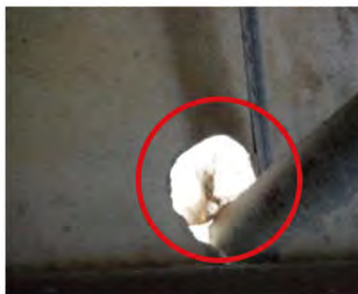
鶏舎壁面の隙間
