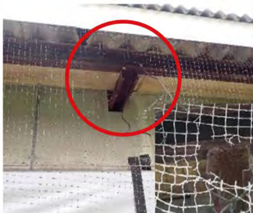
防鳥ネットの破損
