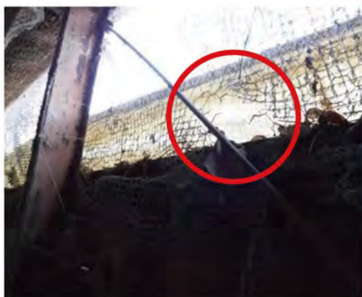
カーテン及び金網の破損
