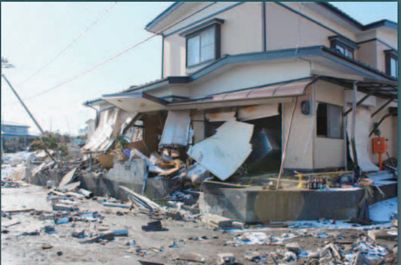
津波による住家被害（階上町）
