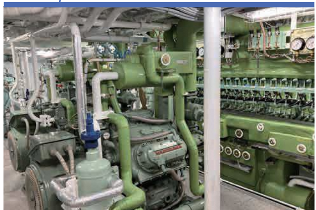
冷凍機室 (FREEZER ROOM)
