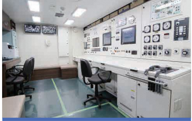
機関制御室 (ENGINE CONTROL ROOM)
