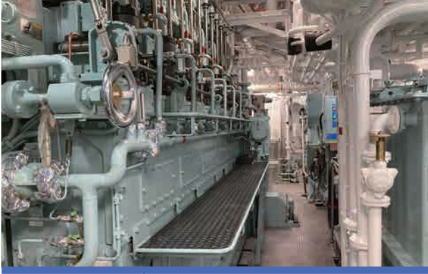
機関室 (ENGINE ROOM)
