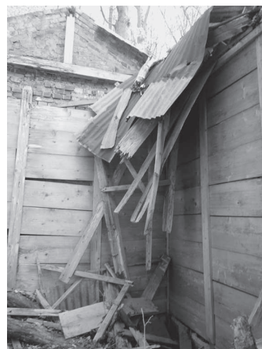
写真18 板張りの内部と崩れたトタン屋根
