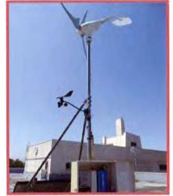
風力発電装置
