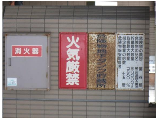
非常用発電設備用燃料貯蔵所
