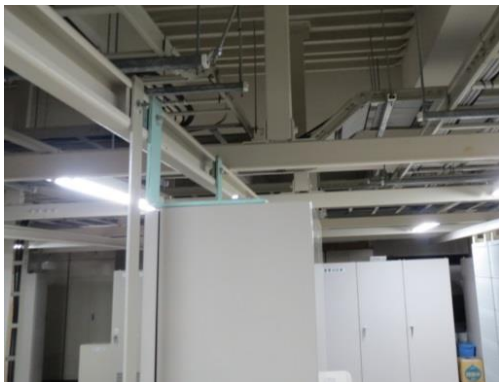
機器類の転倒防止対策
