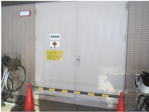
非常用発電設備（本庁舎北棟）
