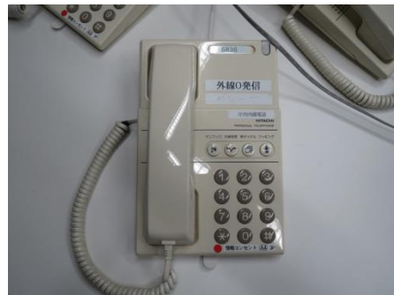
内線電話（本庁舎）
