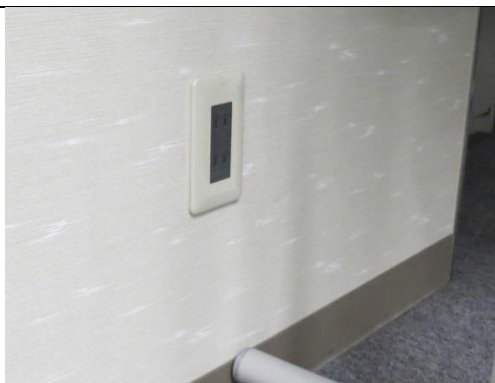
非常時（一次発電機使用時）も使用可能なコンセント（本庁舎北棟）
