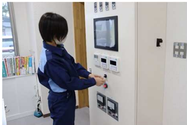
【陽圧化装置稼働】
