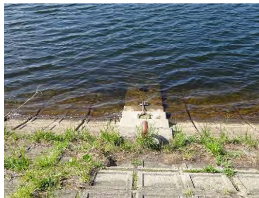
老朽化した取水施設
