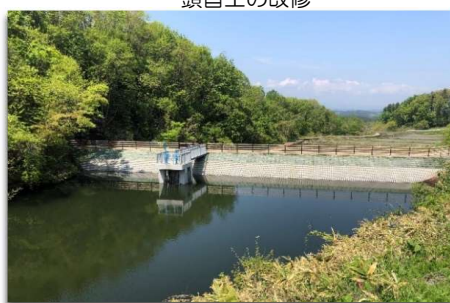
ため池等整備事業 穴久保地区（南部町、H27～H30） ため池の整備
