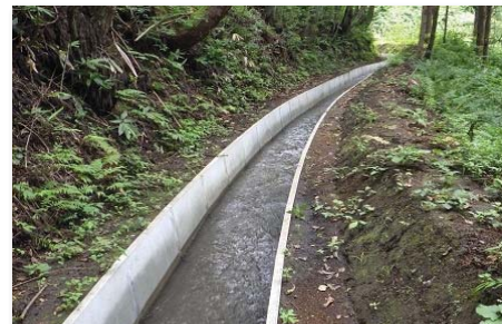
ため池等整備事業（用排水施設整備） 三川目地区（新郷村、H28～R4） 農業用水路の改修
