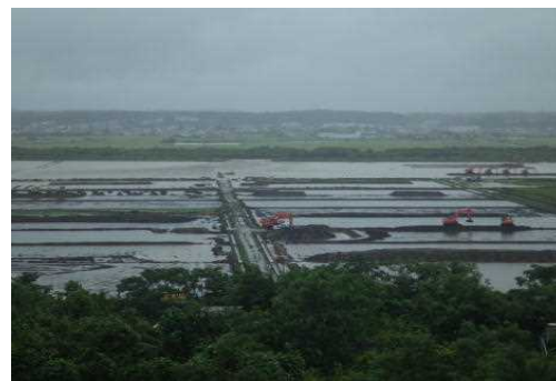
高瀬川が氾濫し、基盤整備工事中のほ場が冠水（東北町）
