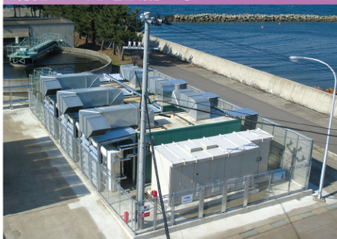
消化ガス発電設備全景
