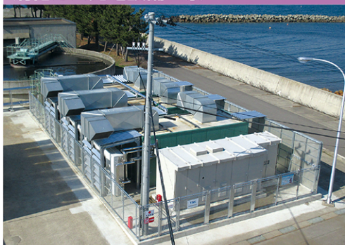
消化ガス発電設備全景
