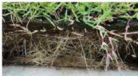
施工1年半後の根付きの様子 基盤と芝生の根が一体化している
