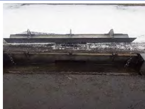
蓋撤去 橋面冠水対応
