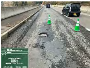
パトロールによる変状確認
