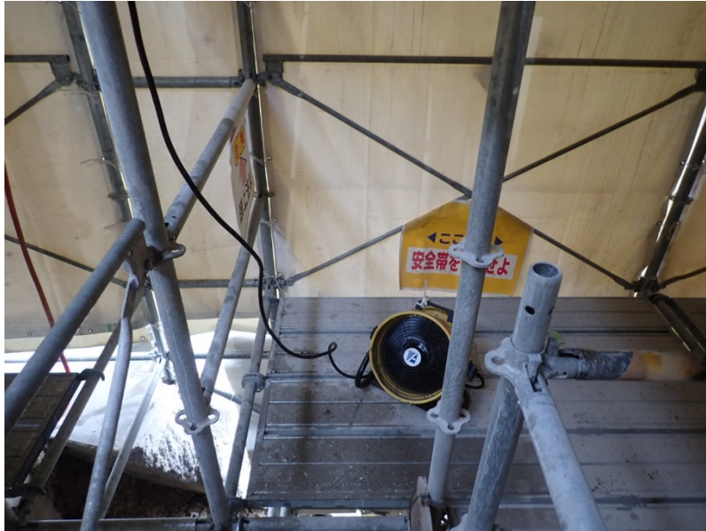
送風機設置状況
