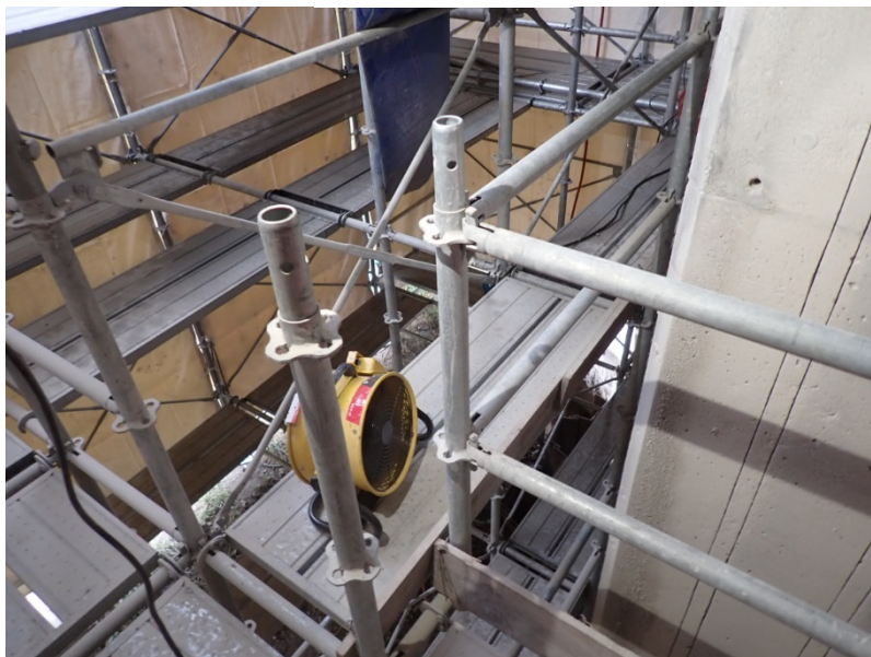
送風機設置状況
