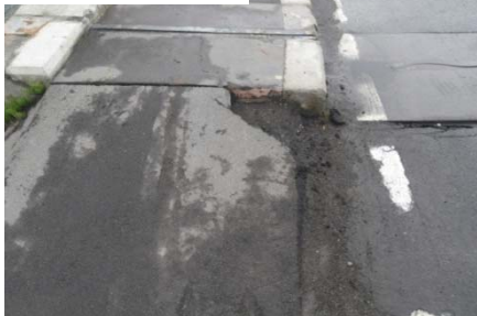
歩道舗装欠損部
