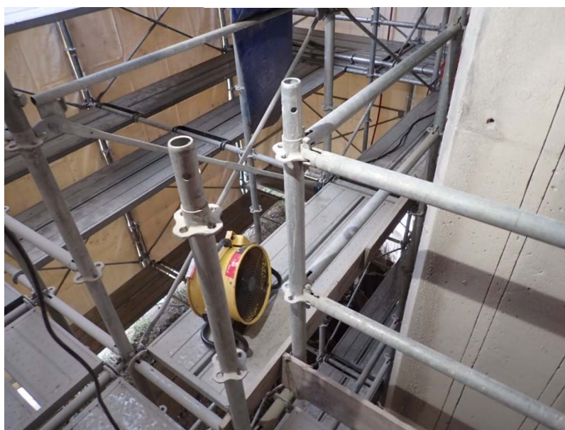
送風機設置状況
