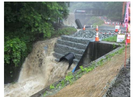
【大雨時でも盛土を維持】
