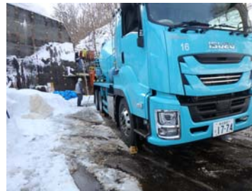
生コン車逸走防止(車止め)
