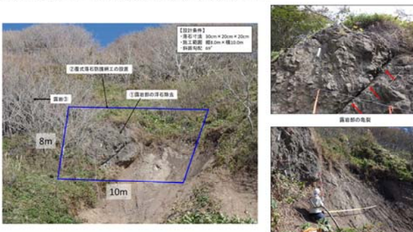
図 3-7 露岩② 対策工範囲全景写真
