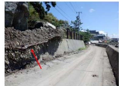
落石防護柵工の破損
