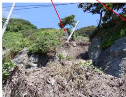
落石、崩壊に伴い電柱が落下
