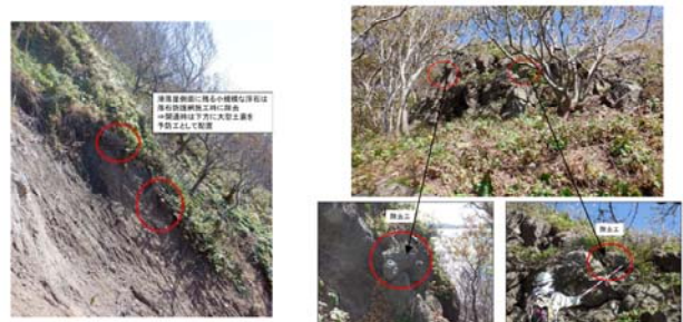
図 3-8 露岩②崩壊地側部の浮石状況写真
