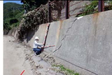
擁壁工の破損
