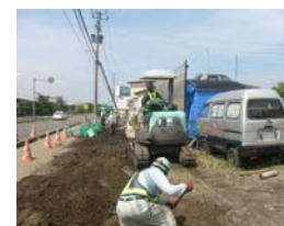
作業半径内監視システム
