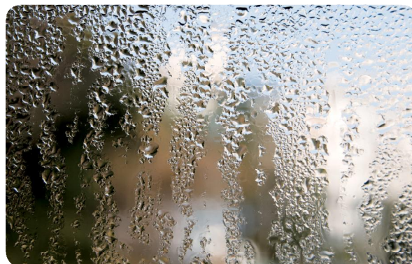
結露 寒い時期に多く見られる。
